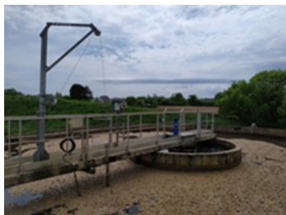
Bassin d'aération de la STEP
