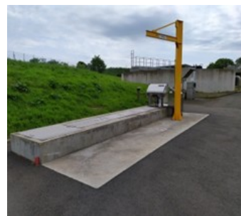
Unité de traitement UV
