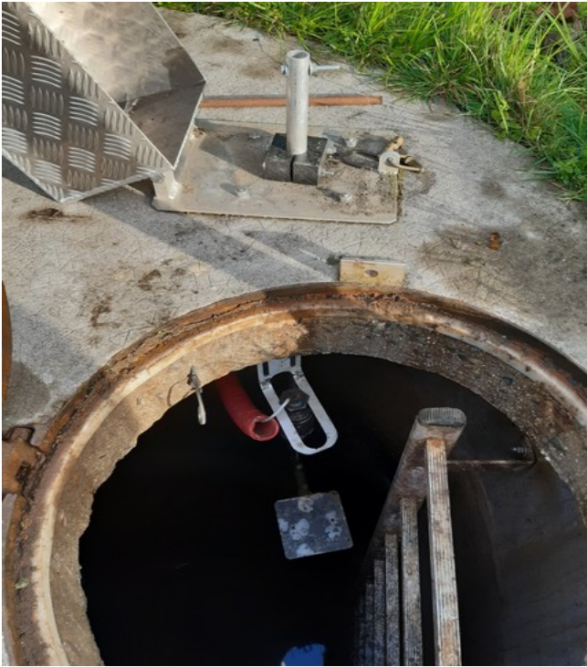
Exemple : mesure de débit avec système de contrôle depuis l'extérieur de l'ouvrage
